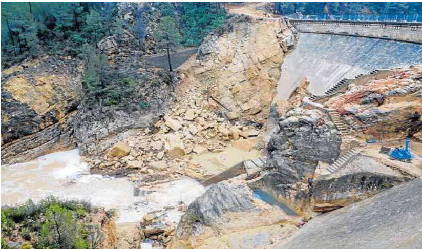
Estado en el que quedó la presa de Buseo tras la dana. IRENE MARSILLA
